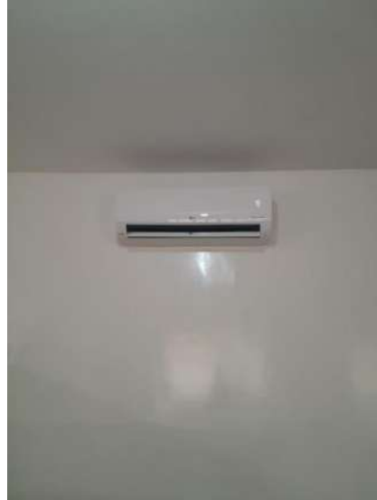
AR CONDICIONADO - ALVORADA
