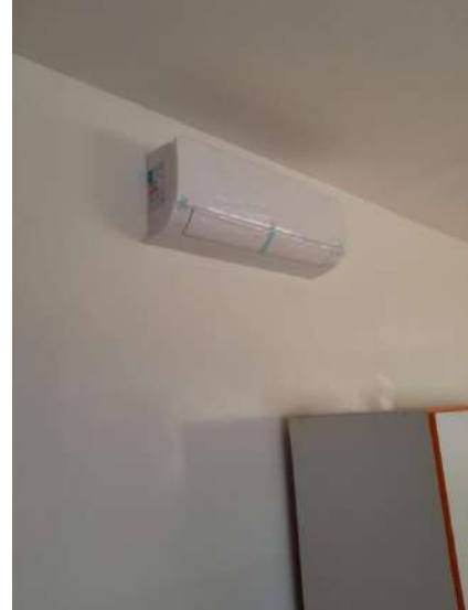
AR CONDICIONADO - ALVORADA
